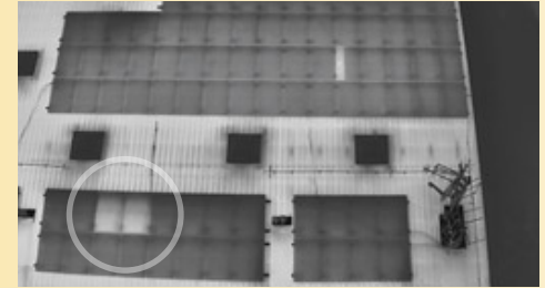
Wärmebild mit fehlerhaften Paneelen
