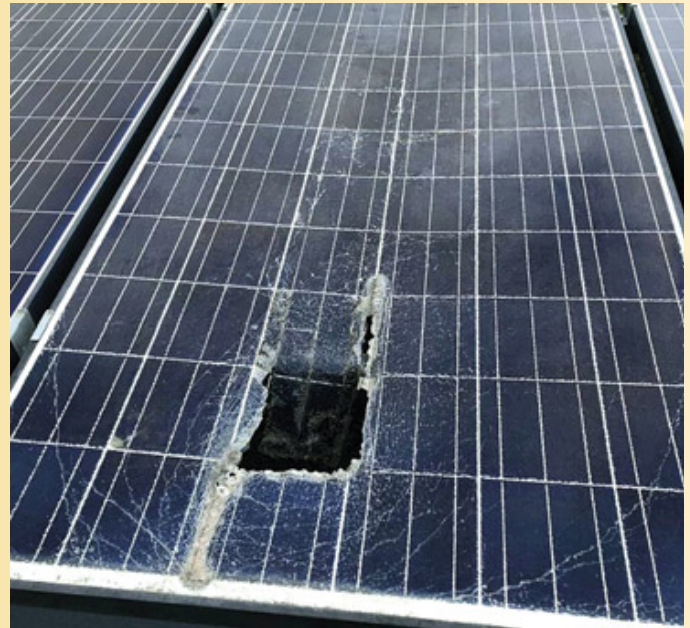
Glasschäden sollten bei Hagelschäden oder bei der Glasversicherung mit gedeckt sein
